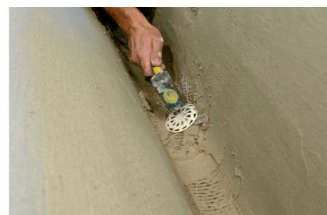
Installazione di Diatono GEOSTEEL e INIETTORE&CONNETTORE GEOSTEEL per l'ancoraggio tra rinforzo e fasce di piano.
