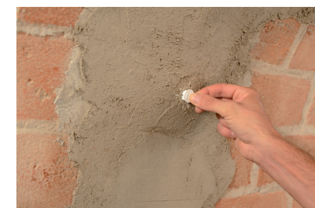
Inghisaggio degli ancoraggi e dei connettori con GEOCALCE FL ANTISISMICO e chiusura del foro di iniezione con apposito tappo di chiusura.
