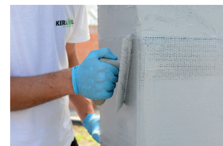
6 Installazione del tessuto in fibra d'acciaio GEOSTEEL e applicazione della seconda mano di GEOLITE GEL.
