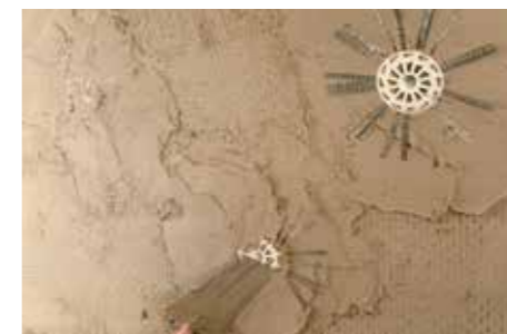
5 Instalação do conector realizado com tecido em fibra de aço GEOSTEEL e INIETTORE&CONNETTORE GEOSTEEL.
