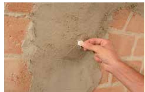
6 Fijación de los anclajes y de los conectores con GEOCALCE FL ANTISISMICO y cerrado del agujero con la tapa suministrada.
